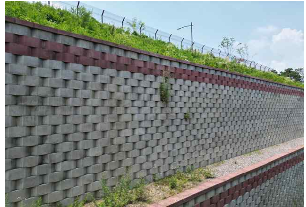
손상내용 옹벽 상단 전면 벽체 식생
