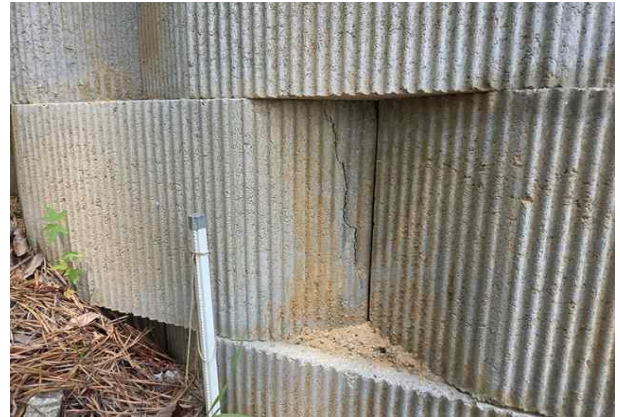
손상내용 옹벽 하단 블록 균열
